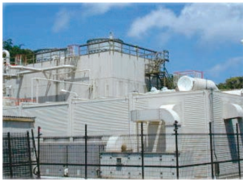
写真9 八丈島地熱発電所（東京都、2023）
