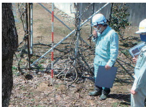
写真-2 漏水箇所③噴砂跡
