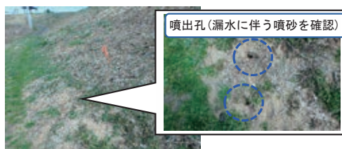
写真-1 漏水箇所①のり尻の噴砂跡
