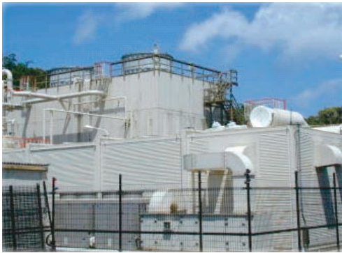
写真9 八丈島地熱発電所（東京都、2023）
