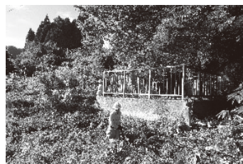
地すべり施設（滝の平地区）集水井
