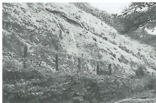
写真-1 法面崩壊状況
