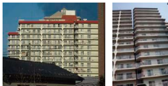
写真3 傾斜したSRC造14階建のSマンション （左）全景（右）Exp. J部の開き
