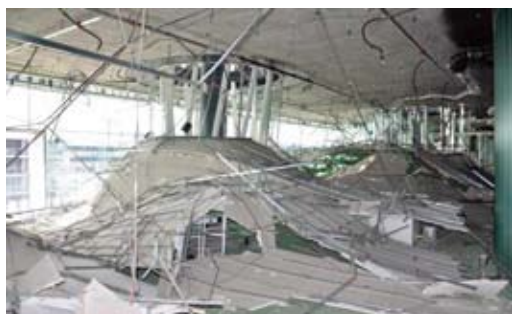
写真7 仙台市青葉区のS複合施設のつり天井落下被害
