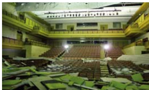
写真8 仙台市太白区の文化センターホールのつり天井落下被害
