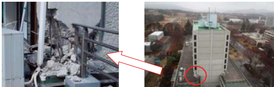
写真1 妻壁両端隅柱の柱脚部の被害状況 10)
