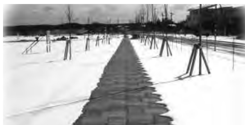
地中熱ヒートパイプ融雪システム
