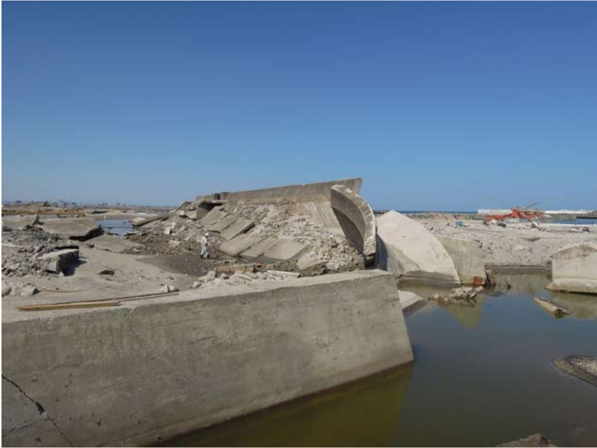
津波により破壊された沿岸部・亶理郡山元町
